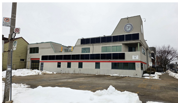
Рисунок 6 – Навесная фотоэлектрическая система на стене здания
