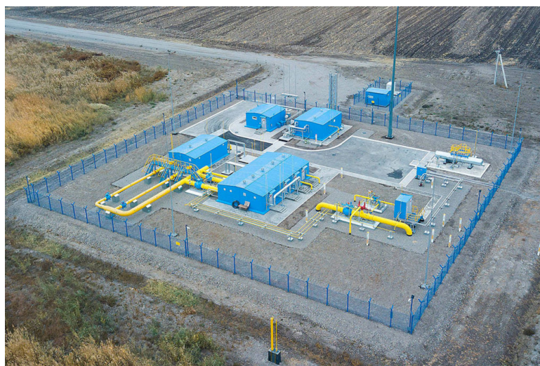
Рисунок 2 – Газораспределительная станция-1 города Бишкека
